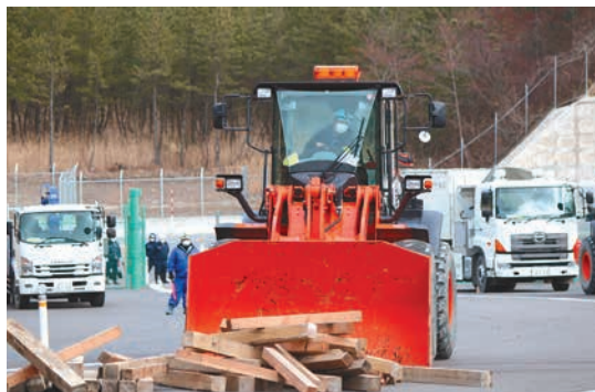
運搬道(アクセスルート)を確保するためのがれき撤去訓練
